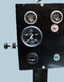
Paneles de arranque y control
